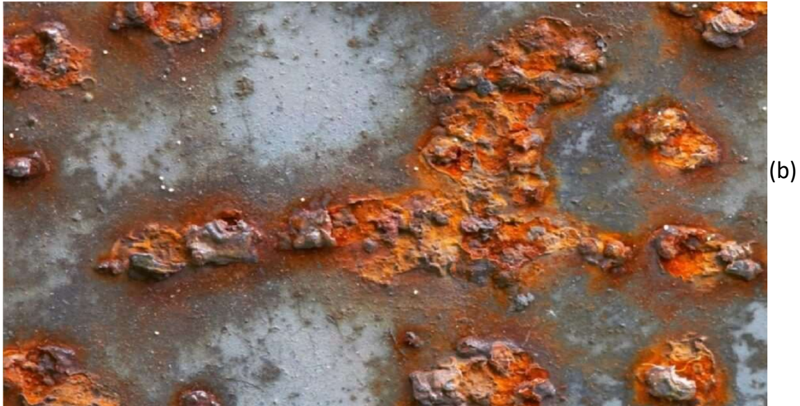
Figura 7 – Corrosão causada por incrustação.
