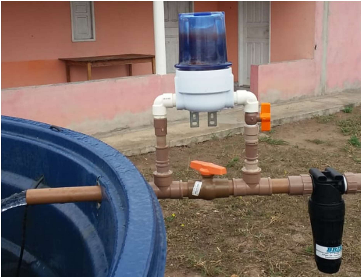
Figura 15 – Instalação padrão: catalisador Eco Íon e dosador de cloro em pastilha.
