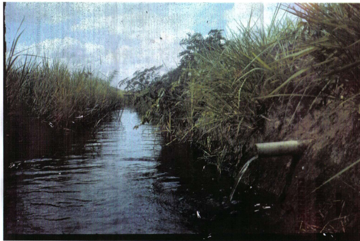
Figura 1 – Drenagem subterrânea e coletora no Vale do Curu – CE.
