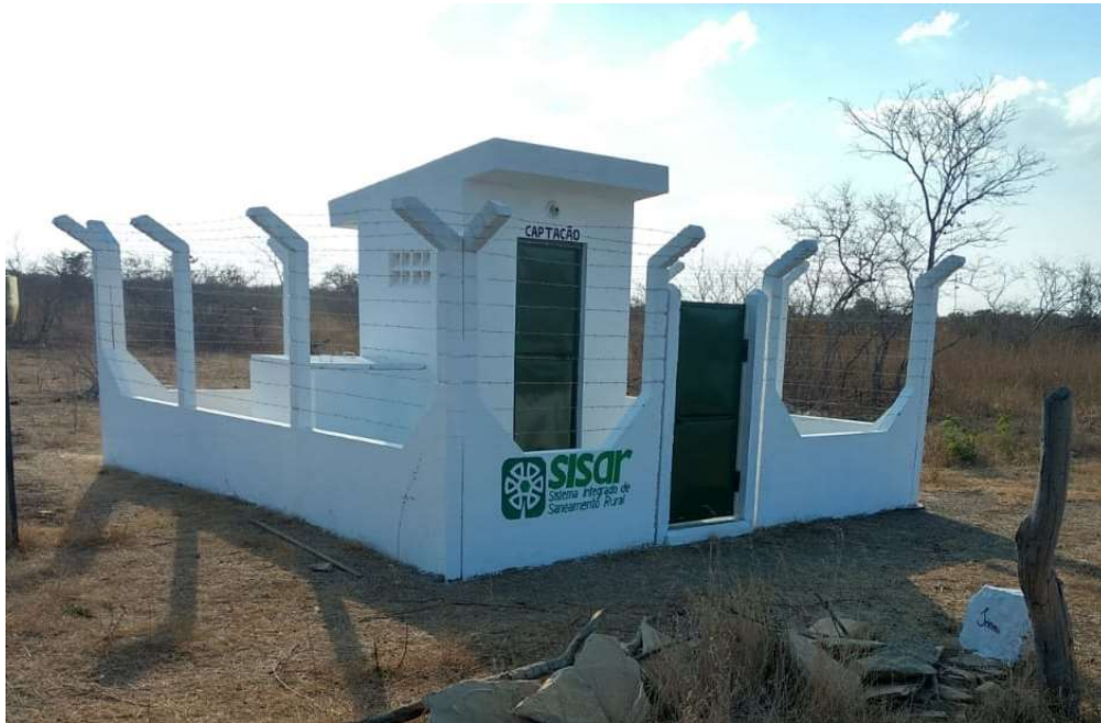
Figura 40 – Área da captação do poço tubular – SAA Serra do Vieira
