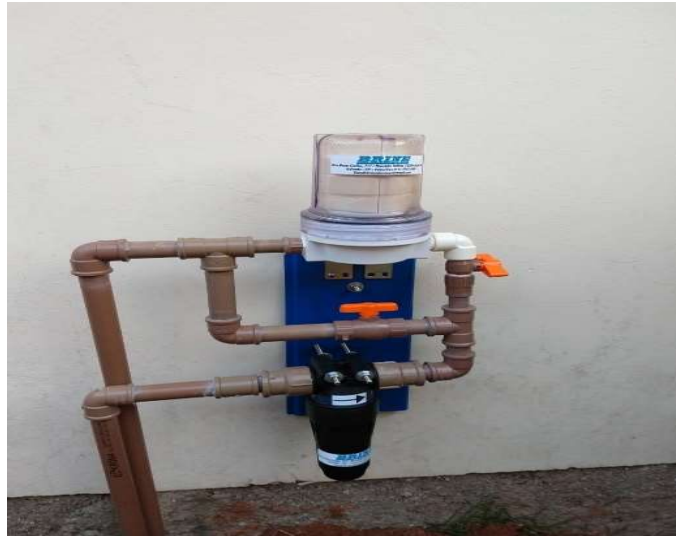
Figura 17 – Foto de instalação residencial de água de poço.
