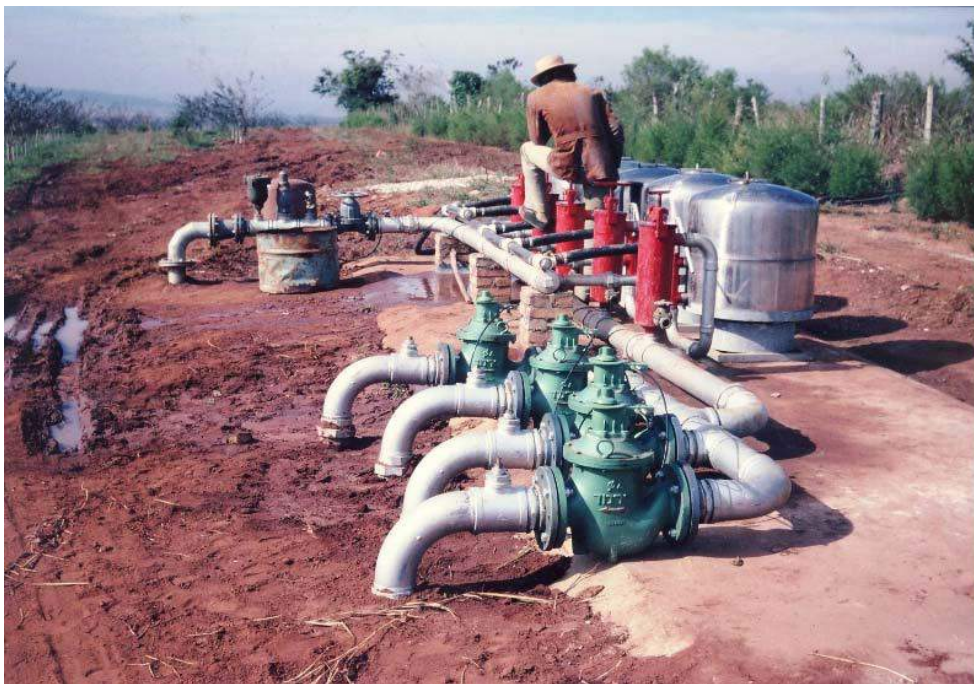
Figura 5. Cabeçal de controle (medição de água, filtragem e fertirrigação) de sistema de irrigação por gotejamento para 122 hectares de cultivo de ameixa, município de Buri (SP), ano de 1978.
