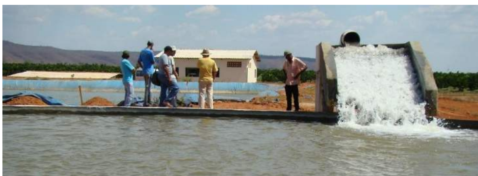
Figura 13. Escada de aeração e depósito decantador (Fazenda Santa Elisa II – Pirapora, MG).
