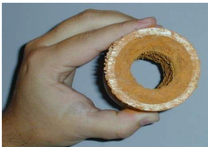
Figura 11. Entupimento por precipitados de ferro.
